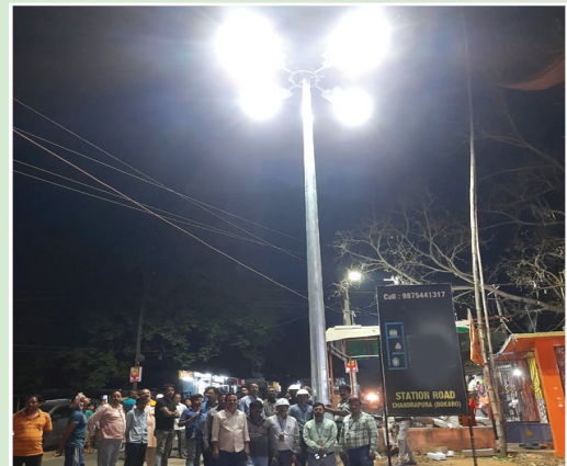
स्टेशन रोड, चन्द्रपुरा में सोलर (सौर ऊर्जा) हाई मास्ट लाइट लगाई गई।
